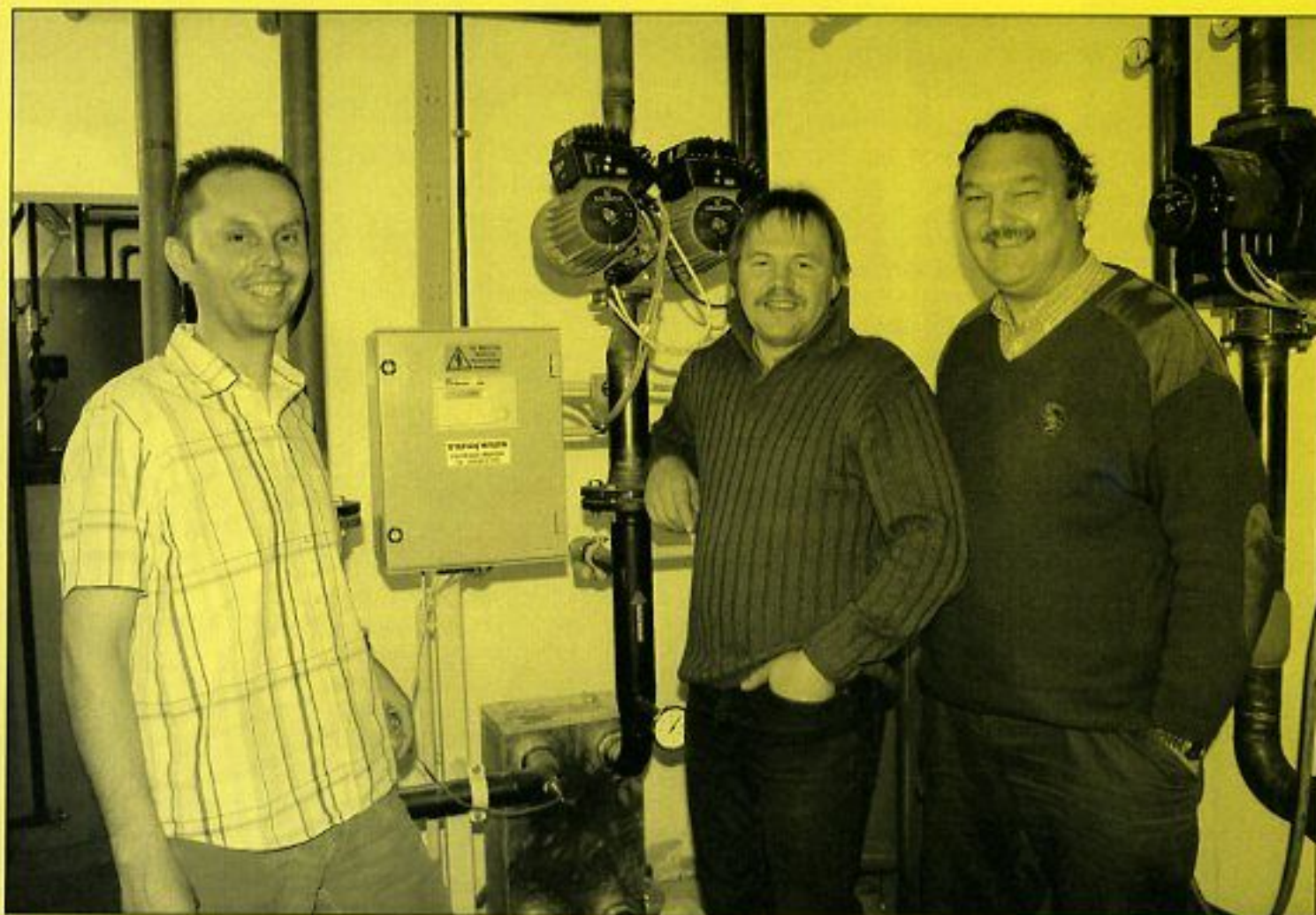
PWH-Leiter Siegfried Sampl, Obmann der Fernwärme St. Michael Hubert Neumann und Bgm. Wolfgang Fanningner bei der neuen Wärme-Übergabestation (Foto: R. Holitzky)
